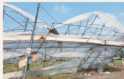
하우스 시설 파손
